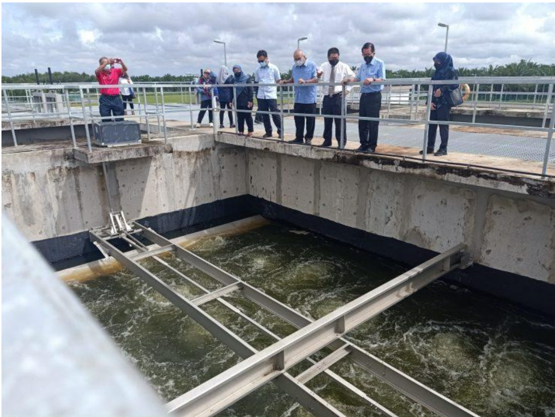
美里中央排污系統處理廠的運作。
