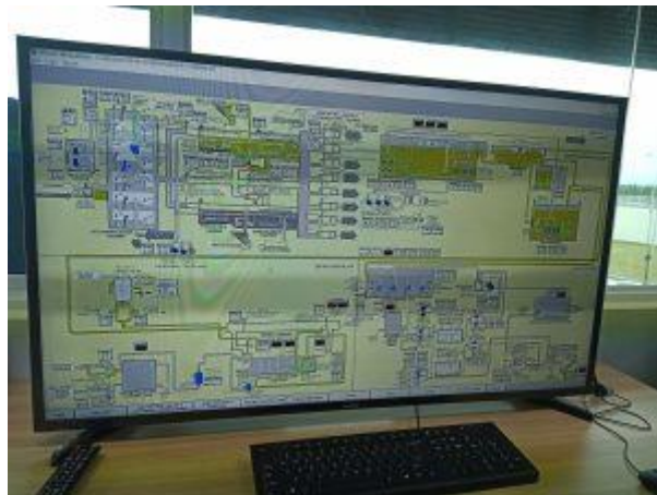
美里中央排污废水处理厂的监测及控制系统。
